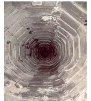
Südturm innen mit Feuchtschäden vor Sanierung
